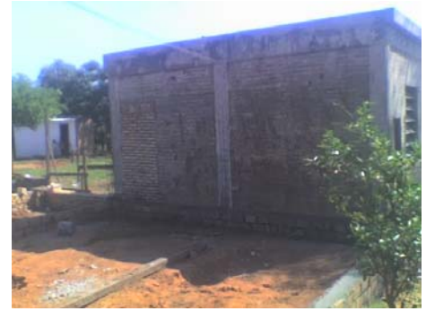
Muro a revocar y aislar
